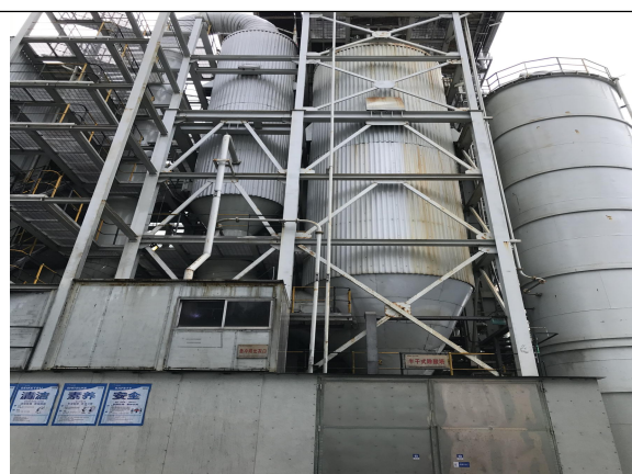
焚烧烟气急冷塔、半干式脱酸塔
